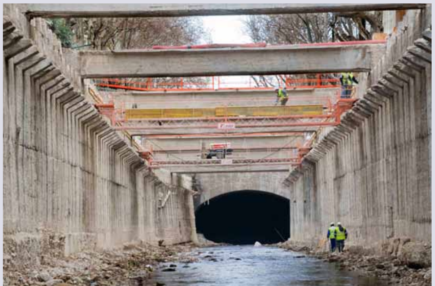
Imagen que presentaba el Huerta a su paso por Gran Vía antes de cubrirlo de nuevo. Cada una de las 288 vigas instaladas para cubrir el cauce pesan 7,91 toneladas
