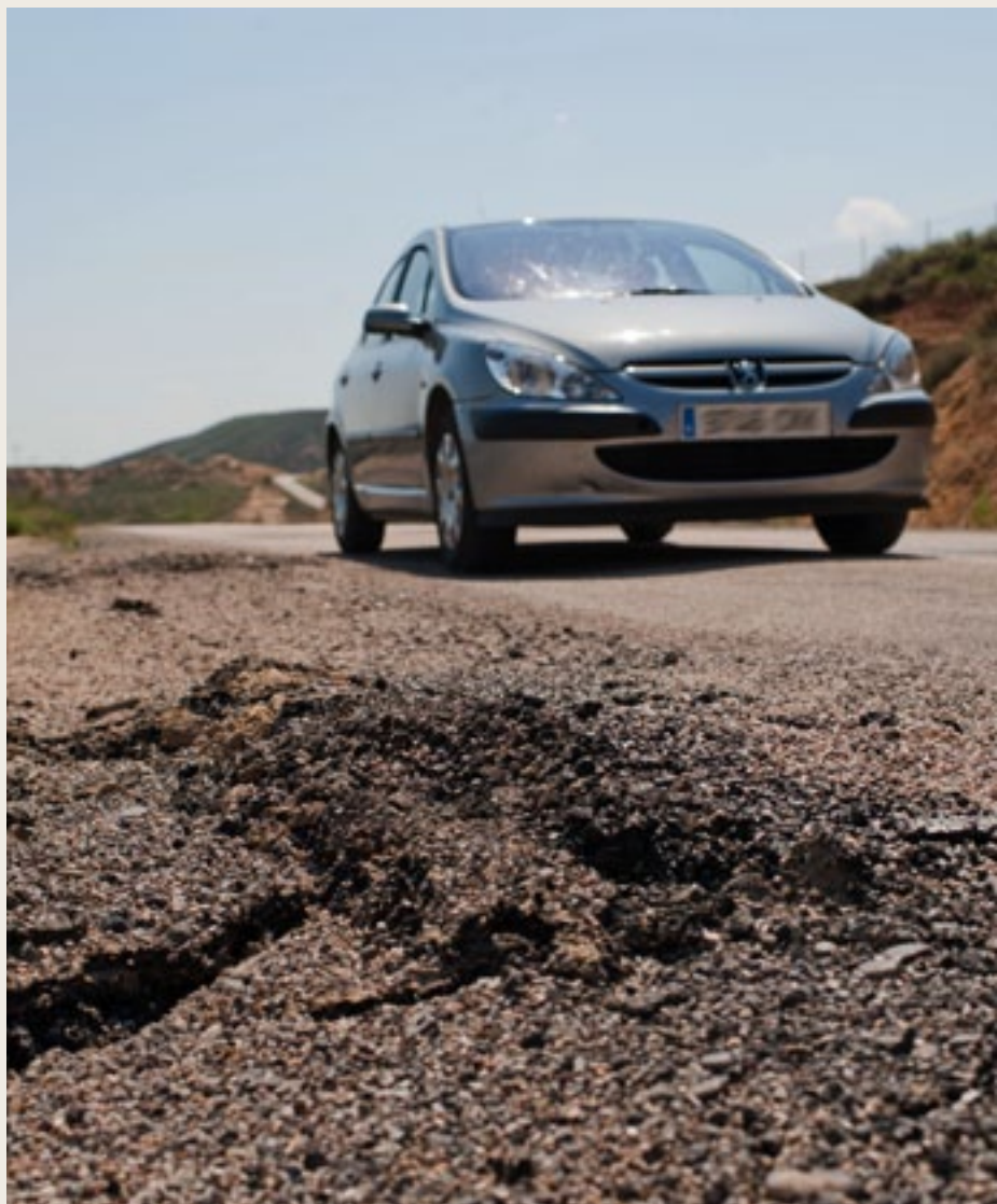
Algunas carreteras aragonesas presentan un estado bastante deficiente.
