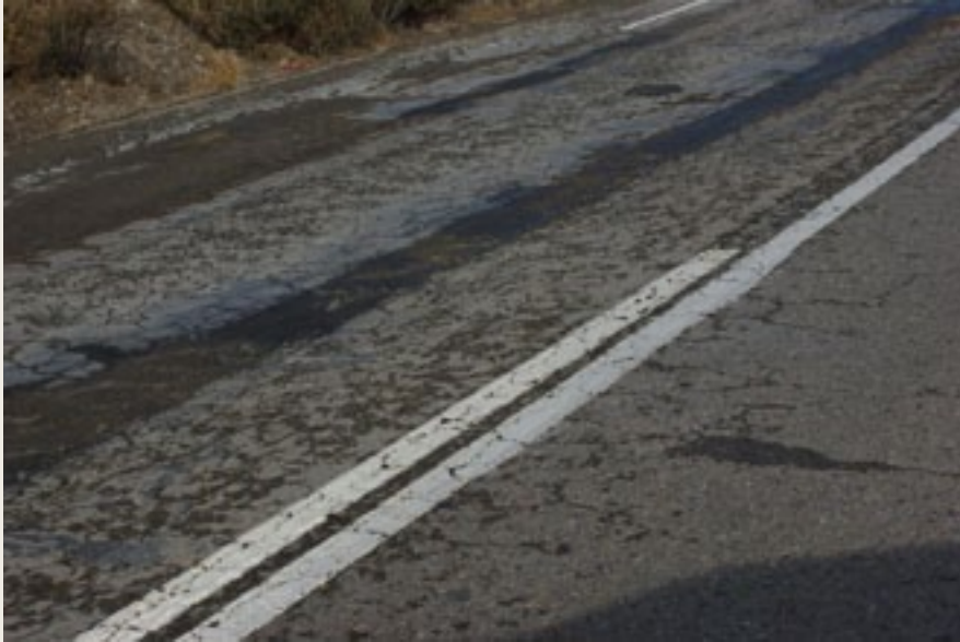
Deterioro del firme en la A-127, entre Gallur y Tauste.
