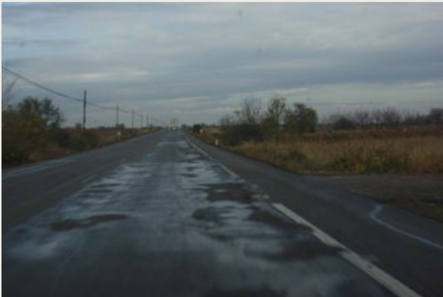
Sucesión de parches de asfalto en la calzada de la A-1303, en Pozuelo de Aragón.
