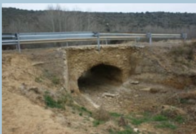
Degradación de un paso inferior de la A-1204, que comunica Ejea y Luesia.
